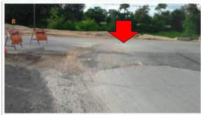
สภาพถนนที่เป็นหลุมบริเวณเขตก่อสร้างเนินลำลี ถนนทางหลวง363
