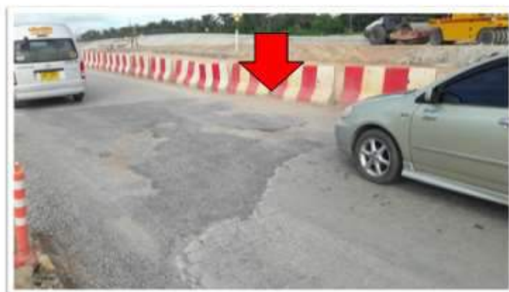
สภาพถนนที่เป็นหลุมบริเวณเขตก่อสร้างเนินลำลี ถนนทางหลวง363
